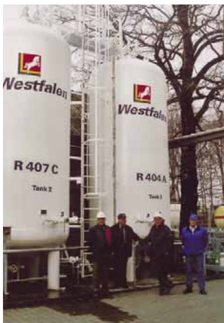
Niemals leer, ständig abrufbereit: Zwei der neben R 134a wichtigsten Kältemittel-Lagertanks im Dienst der Kälte-Klima-Branche
