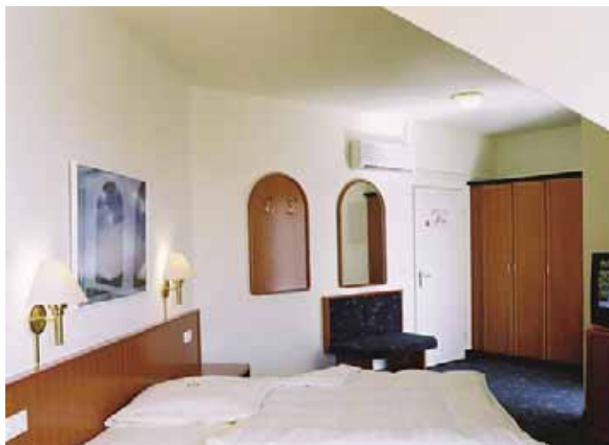
Der nachträgliche Einbau eines VRF-Systems in einem Hotel. Optisch lassen sich Verdampfer recht unauffällig installieren
