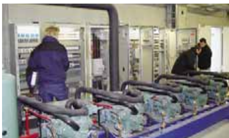
Inbetriebnahme der Kälteanlage bei Globus
