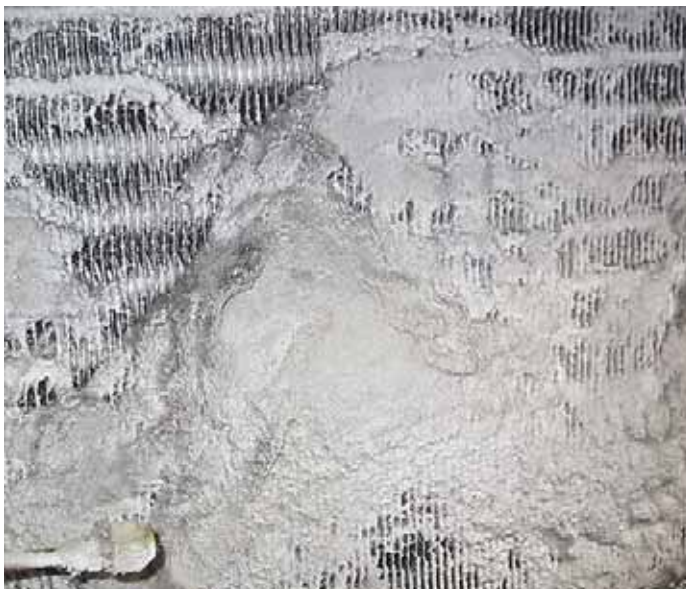
Vereiste Lamellen des Wärmeübertragers: Stromfresser und Kompressorkiller!
