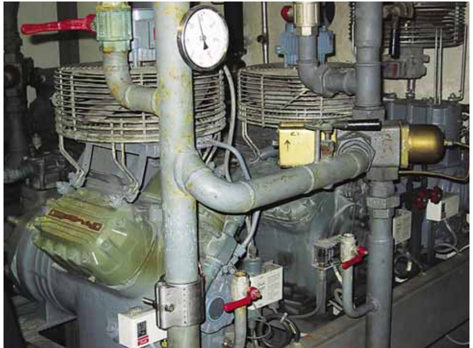
Rost und Überhitzung sind hier deutlich vom Manometer und am Zustand der Unit abzuleiten
