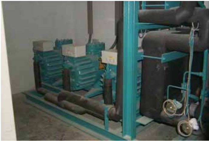
Bild 4 Propan-3er-Verbund im besonderen Maschinenraum
