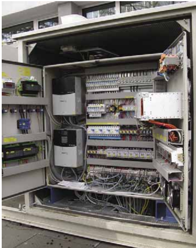
Ein-Blick in den Schaltschrank des neuen Kaltwassererzeugers: Zu erkennen sind die Frequenzumformer sowie auch die Gehäusedämmung zur Schallreduzierung
