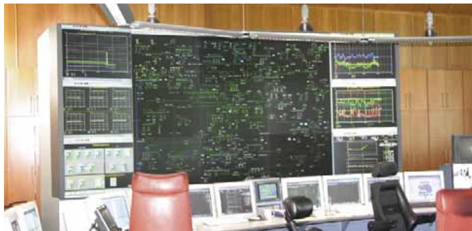
In der Grazer Firmenzentrale der Steweg-Steg befindet sich wie abgebildet, die Schaltwarte sowie die große Monitorwand, für die ein spezielles Kühl-Konzept entwickelt wurde
