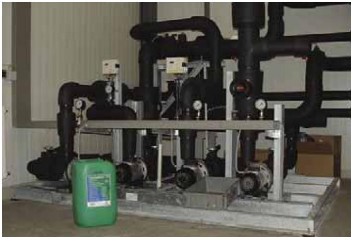
Thermera-Verteilung innerhalb der Anlage bei Phoenix Testlab
