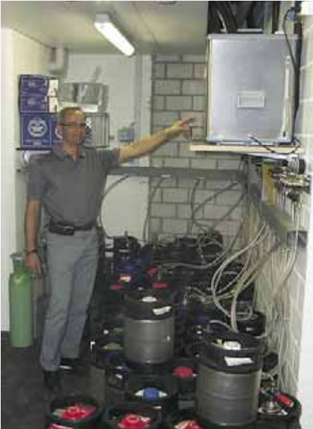
Bild 3 Anlagenplaner und Errichter Paul von Arx zeigt auf die Durchlaufkühler. Diese stellen 3 der 19 Kühlstellen dar
