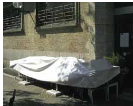
Bild 7 Durch diese Abdeckung über dem Verflüssiger sind Probleme vorprogrammiert! Diese Art der Gartenmöbellagerung ist natürlich tunlichst zu vermeiden, was Betreibern erklärt werden muss
