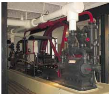
Ammoniak-Doppelverdichter, System Linde, Fabrikat Maschinenfabrik Augsburg, Typ 14 Nr.22 und 23, Gesamtkälteleistung 350 KW
