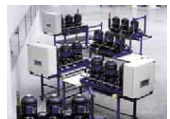
Verbundanlagen mit Trennhaubenverdichtern
