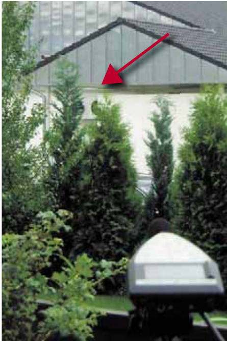
Bild 6 Sichtbar ungünstig montierter Verflüssiger, fotogra- fiert von der Terrasse eines belästigten Nachbarn
