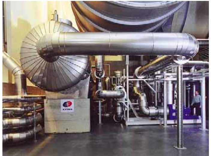
Teilansicht Maschinenraum mit Kaltwassertank und Förderpumpen
