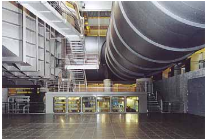
Alles unter Glas – Industriebau und Eventgebäude. Die totale Länge der Stahlrohre für den Windkanal beträgt 141 m, der größte Durchmesser 9,4 m. Im hinteren Bildteil der Maschinenraum der Kälteanlage, natürlich auch der unter Glas
