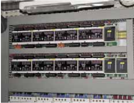
Im Schaltschrank sind die FrigoLink-Geräte zur Datenerfassung zu sehen. Sie sind praktisch die Schnittstelle zwischen der Hardware-„Kälteanlage“ und der Software-„FrigoDataXP“
