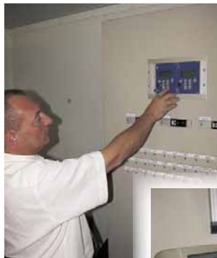
Über ein Display am Schaltschrank kann die Kälteanlage vor Ort bedient werden
