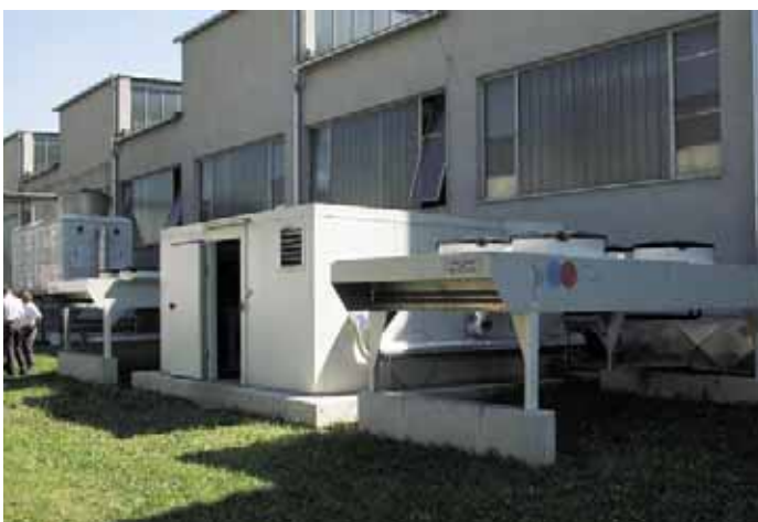
Industrielle Kühlung: Im Maschinencontainer befinden sich die beiden redundant arbeitenden Kälteanlagen. Daneben zu sehen ist der Kondensator, bzw. der Freikühler
