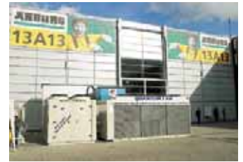
Der auf der Kunststoff-Messe eingesetzte Quantum 1 Air in Containerbauweise eignet sich zur Außen-aufstellung und ist innerhalb kürzester Zeit einsatzbereit
