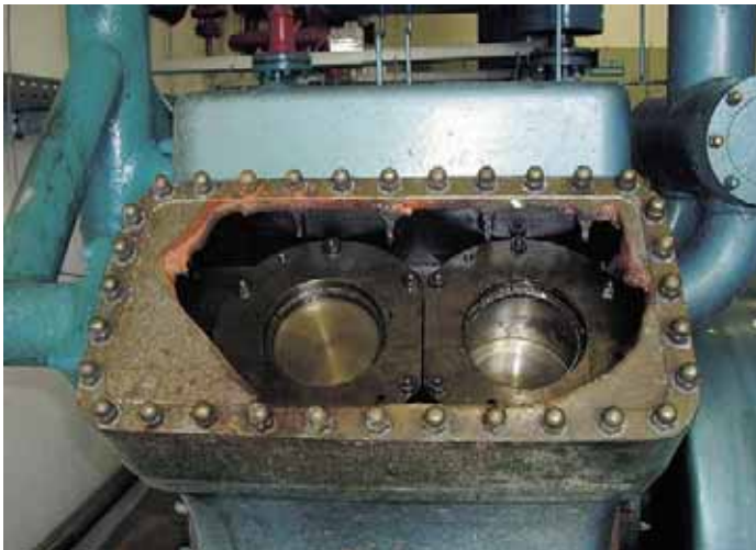
Bild 9 Der Zylinderkopf des Verdichters war geborsten. Im Maschinenraum wurden zwei Bruchstücke vorgefunden, die dem Zylinderkopf zuzuordnen waren
