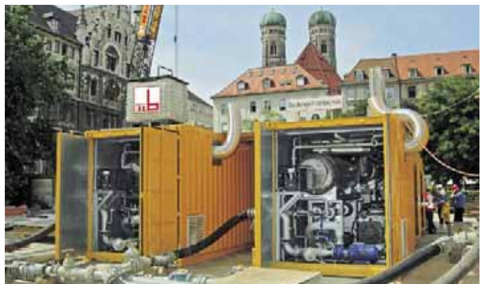
Die beiden Gefrieranlagen auf dem Marienhof
