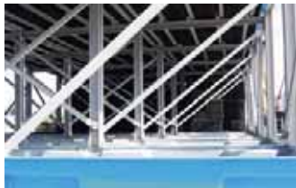
Escher Wyss Kühlturm mit GFK-Tragkonstruktion bei einem großen Zuckererzeuger in Sachsen-Anhalt
