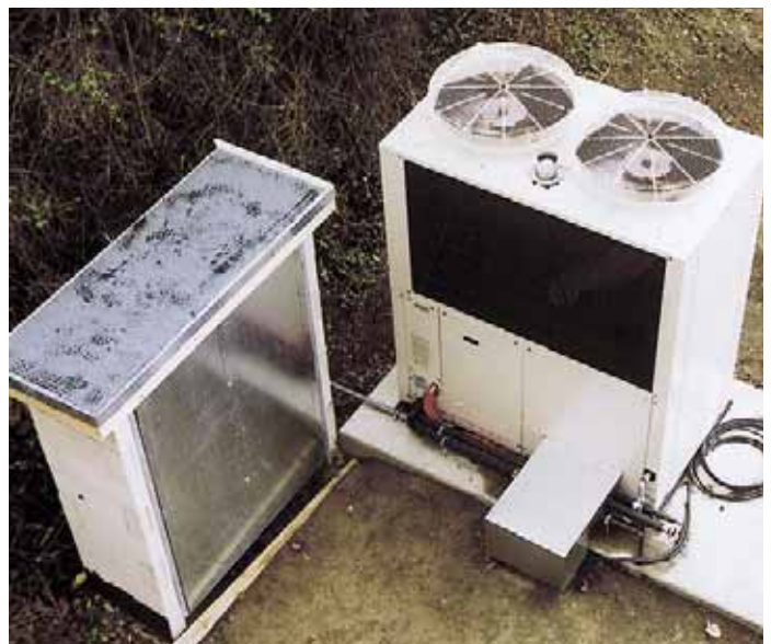
Sanyo ECO Gas-Wärmepumpe Typ SGP-E150J2GU2 für die Funktionen Heizen-Kühlen-Entfeuchten von 23 Zimmern im zweiten Obergeschoss; im rechten Winkel dazu der verkleidete Gasverteiler. Für den Anschluss von zwei weiteren Sanyo ECO Gas-Wärmepumpen zum Heizen und Klimatisieren von Unter- und Erdgeschoss sowie der ersten Etage sind hier schon alle nötigen Vorkehrungen getroffen
