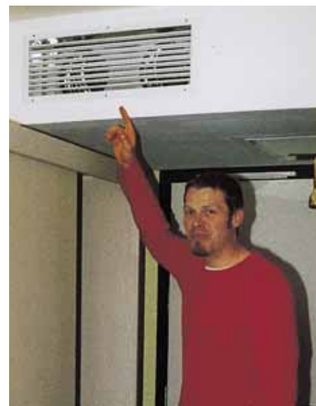
Kälteanlagenbauermeister Sven Plooge, Geschäftsführer des Kälte-Klima-Fachbetriebs Lippelt, Wolfsburg, deutet hier auf den Luftausblas, hinter dem sich das VRF-Inverter-Zwischendeckengerät UR 7-48 befindet
