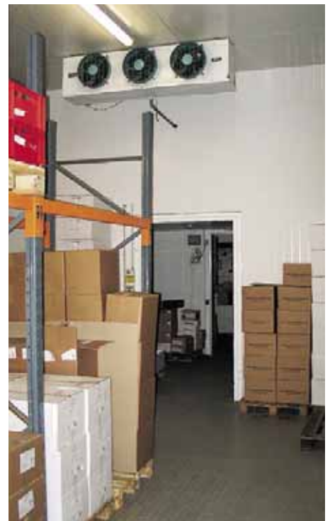
Danfoss-Feldtest an einem Tiefkühlraum in Røddekro (Dänemark)
