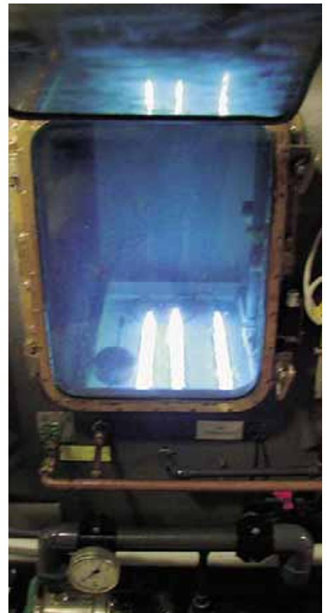
UVC-Bestrahlungsanlagen können effektiv zur Verminderung eines mikrobiellen Wachstums in RLT-Anlagen eingesetzt werden
