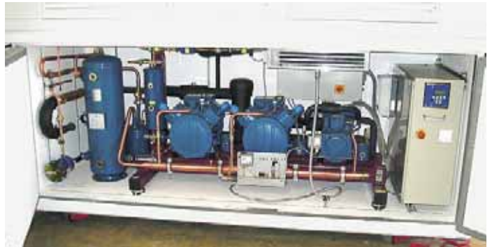
PowerBlock-Verbundsatz für Außenaufstellung am Supermarkt in einer Beton-Umhausung
