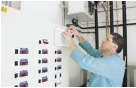
Auch die Maschinenräume mit den beiden Scroll-Verbundanlagen werden gekühlt
