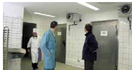
In den gekühlten Bereichen der Großküche werden Küba SGB Verdampfer mit Textilschlauchadaptern für die zugfreie Luftverteilung eingesetzt. Hier noch vor der Montage der Textilschläuche
