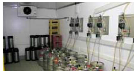
Fußball und Bier, das gehört irgendwie schon zusammen. Ein Küba Ventilatorluftkühler der Baureihe SPB031C mit CAL-Verteiler sorgt hier im Getränke Kühlraum für eisfreie Verdampferrohrlängen
