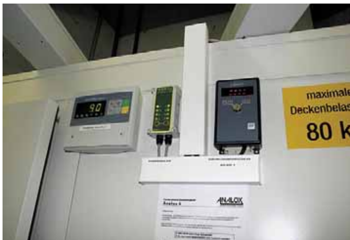
Steuerung Kühlzelle, Gaswarnanlage und Wasserdurchflussmengenmesser, an einer der Kühlzellen außen gut sichtbar angebracht
