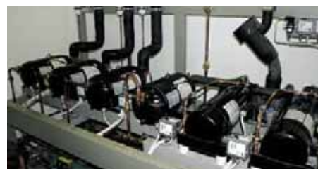
Im Bereich der Kühlräume für das Familienrestaurant (Ebene 03) und für die Hauptküche (Ebene 04) konnten die Verflüssigereinheiten zu zwei wassergekühlten Verbundanlagen mit liegenden Hitachi-Scrollverdichtern zusammengefasst werden
