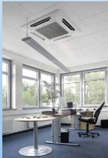
Zentrale oder dezentrale Klimatisierung?
