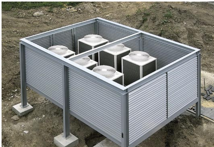
6 Sanyo-ECO-Multi-Außeneinheiten mit dem Kältemittel R410A und einer Gesamtkühlleistung von 180 kW wurden hochwassergeschützt auf einer Stahlkonstruktion neben dem Gebäude installiert
