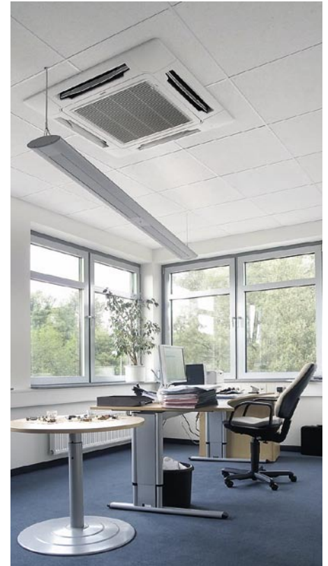
30 Büro- und Besprechungsräume wurden über 4-seitig ausblasende Deckenkassetten durch die VRF-Multi-Split-Systemtechnik klimatisiert. Gesamtinstallation durch den Kälte-Klima-Fachbetrieb Redeker Kältetechnik GmbH & Co. in Lage
