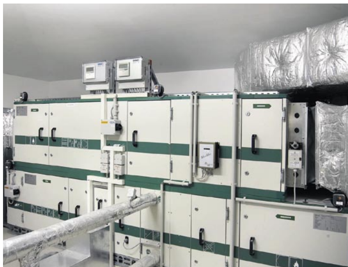
Zentrale RLT-Anlage mit max. 6400 m 3 /h Luftleistung und Wärmerückgewinnung zur Klimatisierung der Mensa. Der Wärmeübertrager ist in die VRF-Multisplit-Technik integriert
