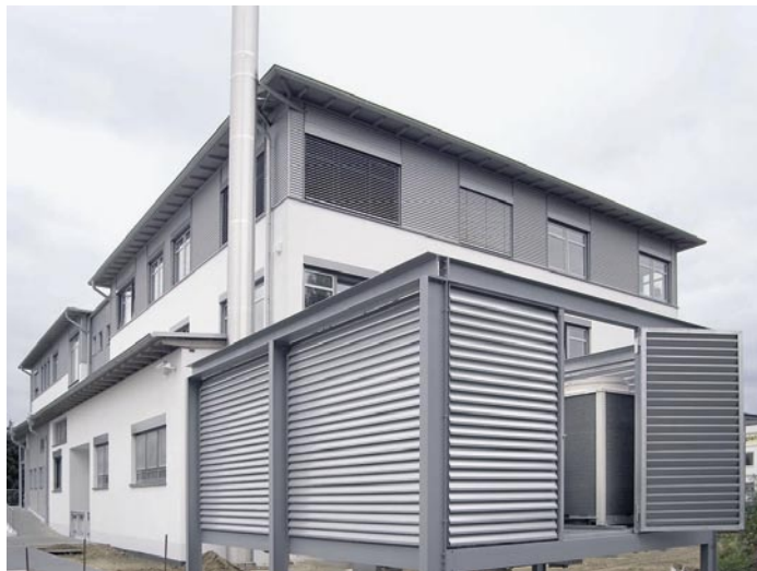
Gebäuderückseite der Ecclesia Detmold mit daran angebauter VRF-Außengeräte-Zentrale und zweckdienlichen Luftansaugittern
