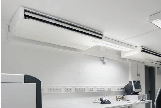
Klimatisierung des Serverraumes durch Unterdecken-VRF-Module
