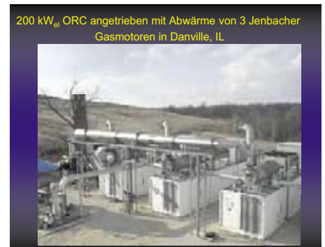
Bild 7 Installierte ORC-Anlagen mit verschiedenen Wärmequellen
