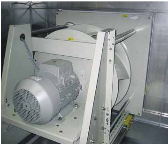
Bild 4 Der Einsatz eines direkt angetriebenen Radialventilators (hier ein Freiläufer der Firma Ziehl Abegg) senkt den Energiebedarf. Ein Riemenantrieb wäre aus hygienischen Gründen bedenklich gewesen
