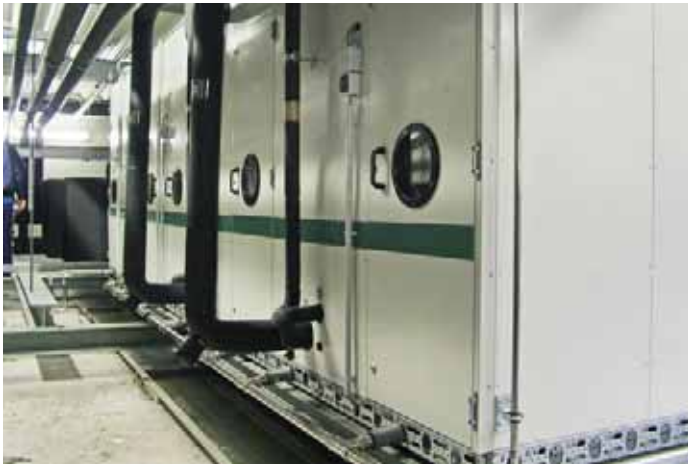
Bild 2 Das CCC-Gerät auf Basis des GEA ATplus im Installationsgeschoss. Hier ist die Versorgung mit den Kalt- und Warmsoleitungen ersichtlich. Als Warmsole ist Ethylenglykol (33%) im Einsatz
