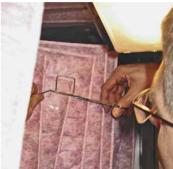
Bild 7 Überprüfen des Filtervlieses: Die durch den CCC-Kühler mögliche Ionisation und niedrige Temperaturen zeigen Wirkung. Sie sorgen für extrem niedrige Keimzahlen in der Fleischverarbeitung
