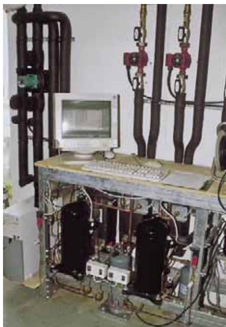
Wärmepumpen-Versuchsanordnung mit Scroll-Verdichtern und Platten-Wärmetauschern. Überwachung und Protokollierung der Messdaten mittels PC
