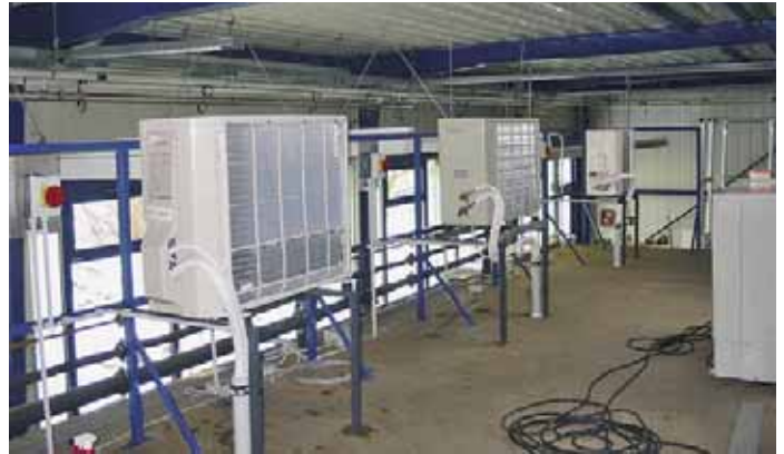
Die Außeneinheiten von Klima-Splitanlagen wurden in der NKF auf dem Dach der Kühlzellen platziert
