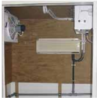
Blick in eine der Kühlzellen; in der Mitte ist eine Wand-Innenheit montiert, rechts ein Ventilatorluftkühler einer Verbundanlage, links der Verdampfer einer Übungsanlage
