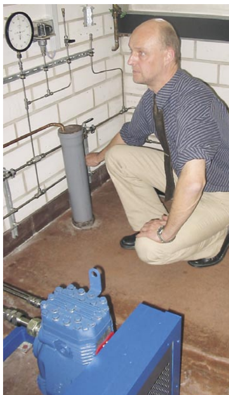
Ingo Kluge bei der Inbetriebnahme der Laborkälteanlage, im Vordergrund der offene Zweizylinderverdichter (Fa.Bock)
