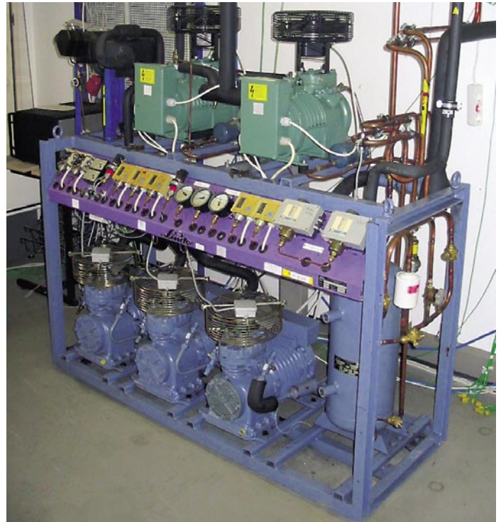
Bild 1 Linde Verbundsatz; oben: Tiefkühlung, unten: Pluskühlung
