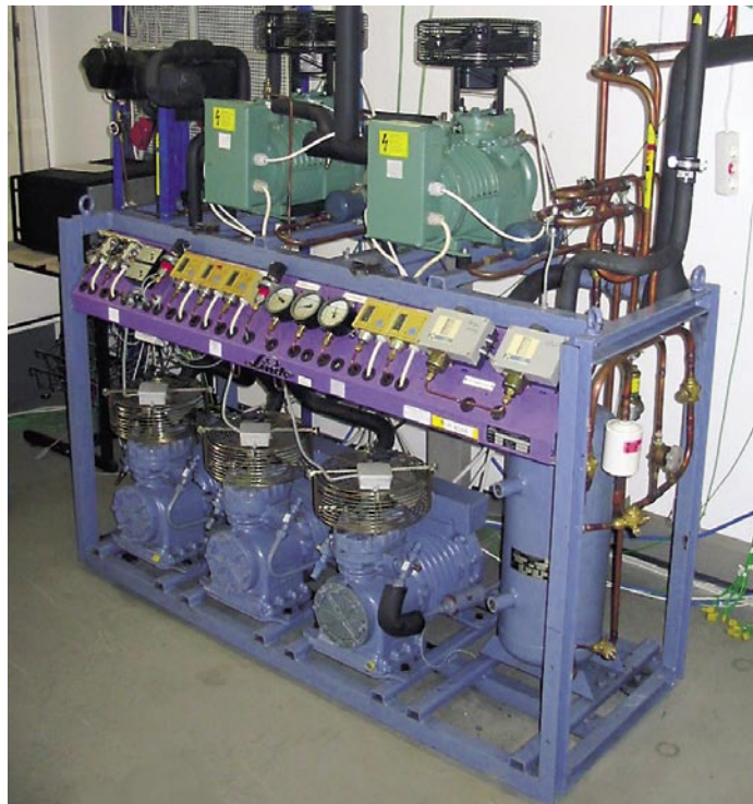
Bild 1 Linde Verbundsatz; oben: Tiefkühlung, unten: Pluskühlung
