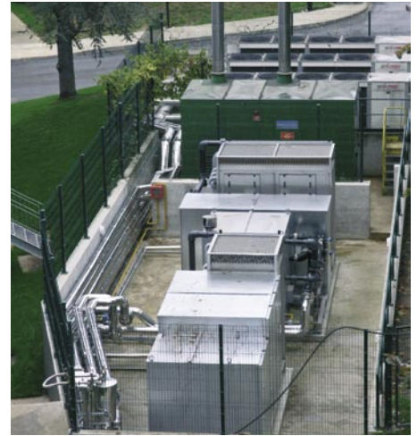
Rund 100 kW werden durch Solarenergie geliefert, der Rest durch einen gasbetriebenen Yazaki Absorptionssatz und drei klassischen Lennox Trockenkühler
