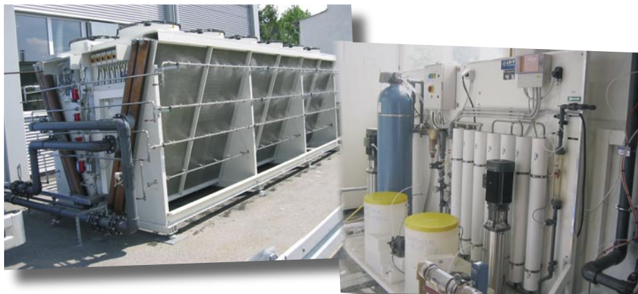
Wet&Dry-System und Osmose-Anlage
