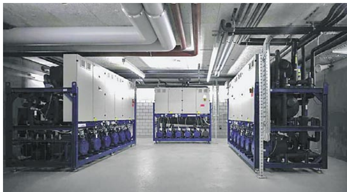
COOP Megastore in Wettingen NK-Verbundanlage für Kühlinseln und -Regale
