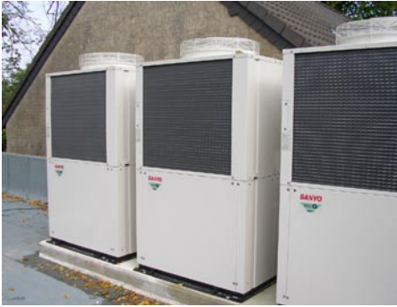
Installierte Gas-Wärmepumpe mit 3 Außengeräten, Fabrikat Sanyo, Gesamtleistung 78 kW im Kühlbetrieb und 84 kW im Heizbetrieb
