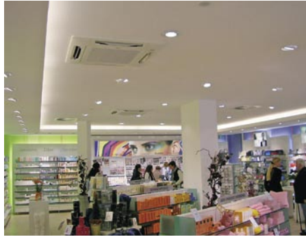
Innenbereich des Drogeriemarktes Douglas, klimatisierte Fläche 250 m 2 durch 4-seitig ausblasende Deckenkassetten, Fabrikat Kaut/Sanyo
