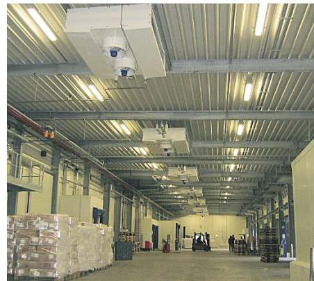
Raffel Kühler in einer Lagerhalle in Hamburg: Sonderanfertigungen für NH 3 -Betrieb, sieben Geräte aus der Reihe DF80/10-6x6x2200 und zwei Geräte aus der Reihe DF 80/10-6x6x800
