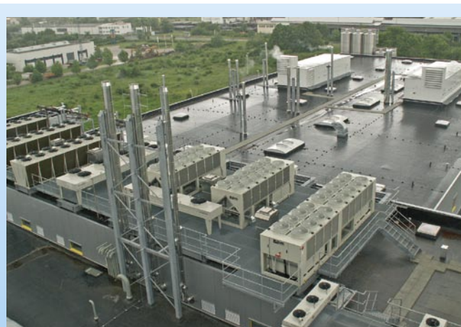
Meisterleistung von Kälte-Technik Eisleben
