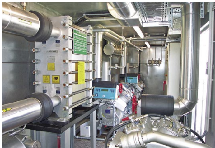
CO 2 -Teil im Container
