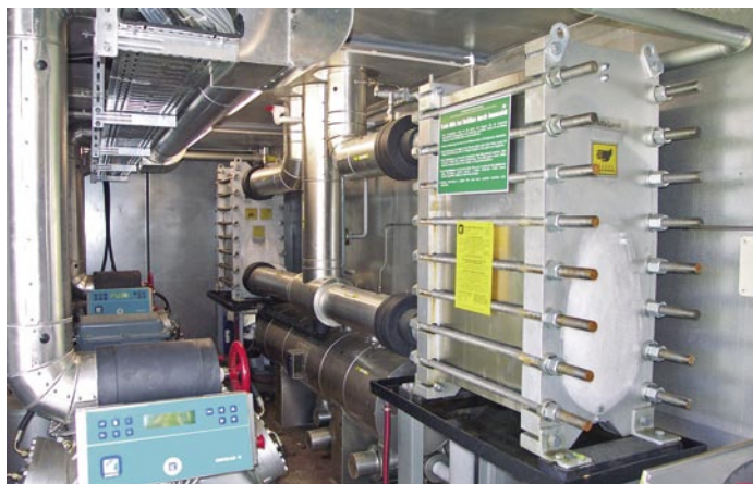
NH 3 -Teil im Container
