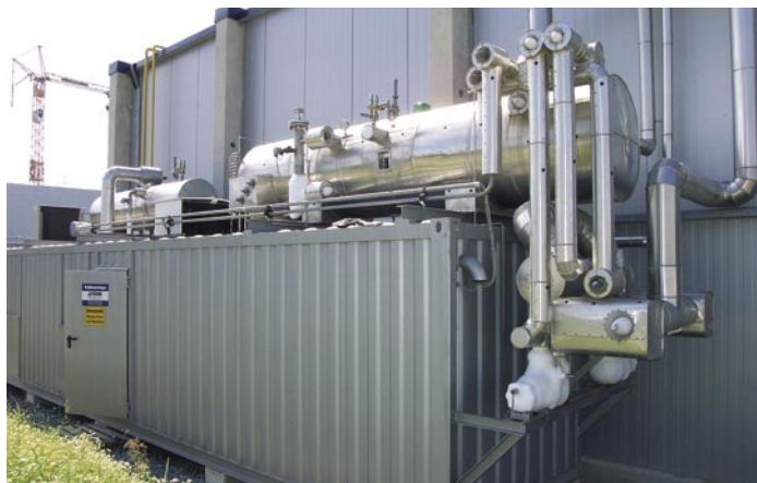
Außenansicht (Container) der zweistufigen CO 2 /NH 3 -Kälteanlage bei M+P Tiefkühlkost, Bielefeld
