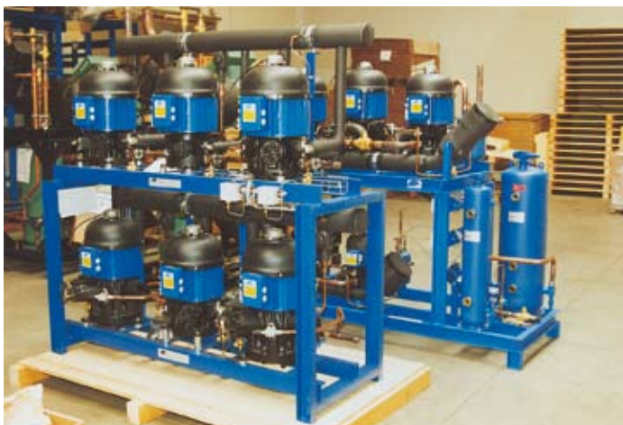
2 Frigopol-Verbundsätze für zwei Supermärkte, jeweils 2 Plus- und 1 TK-Trennhaubenverdichter
