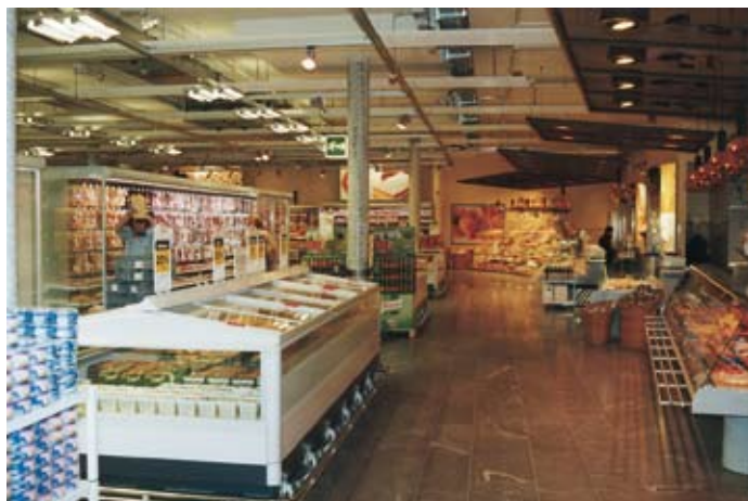
Coop Interlagen Ost. Nach der großen Überschwemmung im August 2005 entschloss sich die Coop-Zentrale zu einem totalen Umbau der kältetechnischen Einrichtungen während des laufenden Betriebs. Eines der Bilder zeigt hier Christian Rubin (Leiter Kundendienst) vor der Copeland/DWM-Kältemaschine für die Klimaanlage der Metzgerei, die 3 Wochen lang „gebadet“ hat und heute wieder funktionsgerecht ihre Aufgabe erfüllt
