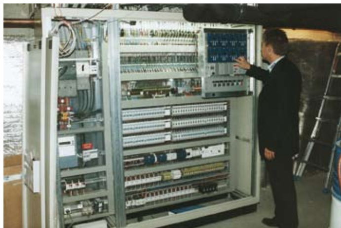
Schaltschrank-Zentrale mit DFÜ von Wurm Frigolink
