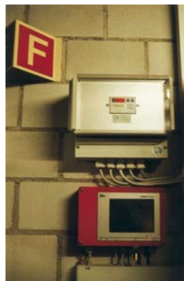
CO 2 -Schnüffler (Gassensor), installiert in jedem Tiefkühlraum; bei 1% Voralarm, bei 2% „scharfer“ Alarm
