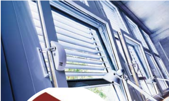
Bild 3 Auch die Lüftung über die Fenster ist Teil des Lüftungskonzeptes und gilt es zu berücksichtigen
