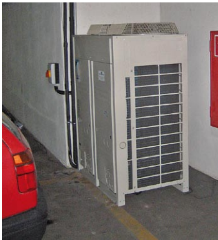
Die kompakten Außengeräte mit einer externen Pressung von 78 Pa konnten problemlos in zwei Nischen im belüfteten Parkhaus untergebracht werden
