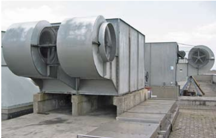
Teil einer Kühlturmanlage zu einer Klimakälteanlage, Ventilatoren umgebaut auf Drehzahlregelung
