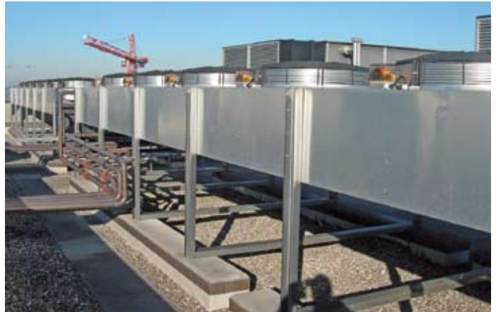
Luftgekühlte Verflüssiger zu den Wasserkühlmaschinen
