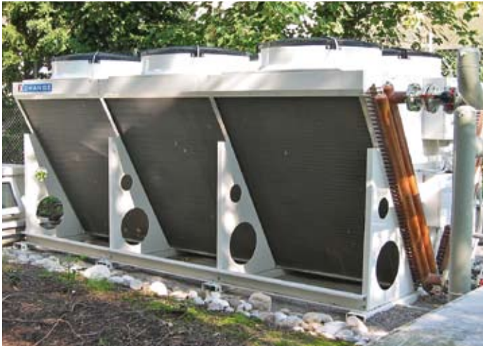
Trockenluftkühler für Sole im Kühlkreislauf
