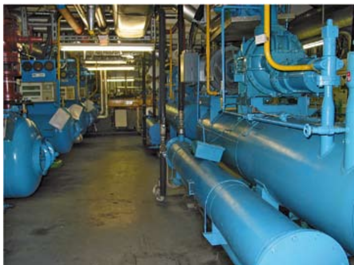
Blick in den Maschinenraum mit 11 Schraubenverdichtern
