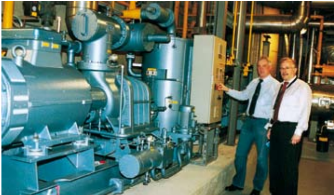
Ein Eindruck aus dem Maschinenraum mit einem der beiden Schraubenverdichter, die zusammen über eine Kälteleistung von 1028kW verfügen. Hier mit einigen Erläuterungen durch Bernd Zeitvogel (l.), als Deputy General Manager für das gesamte Testing Department verantwortlich, und Dr.-Ing. Frank Rinne, in gleicher Position Leiter der Vorentwicklung und Forschung
