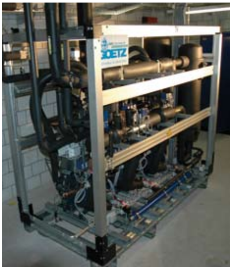
Transkritische Tiefkühlanlage CO 2 mit 3 zwei-stufigen Dorin-Verdichtern in Verbundbauweise. Kälteleistung 50kW, t 0 = -33 °C (12 bar), Hochdruck 45–85 bar
