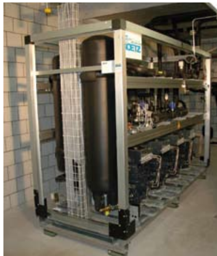
Transkritische Pluskühlanlage CO 2 mit 4 ein-stufigen Dorin-Verdichtern in Verbundbauweise. Kälteleistung 90kW, t 0 = -10 °C (26 bar), Hochdruck 45–85 bar
