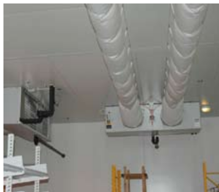
Ventilatorluftkühler, Fabrikat Küba, mit Luftverteilung über Schläuche, für den Pluskühlbereich
