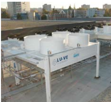
Wärmeabgabe über Gaskühler, Fabrikat LU-VE Contardo, Ausführung 2-kreisig, Leistung 90kW
