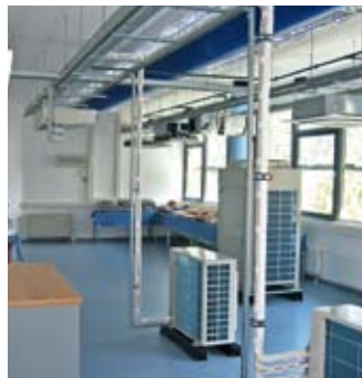
Schulungsraum im neuen Daikin Regionalbüro in Stuttgart
