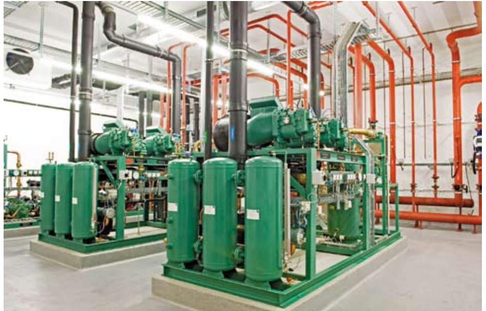
Maschinenraum mit friosol-Verbundanlagen
