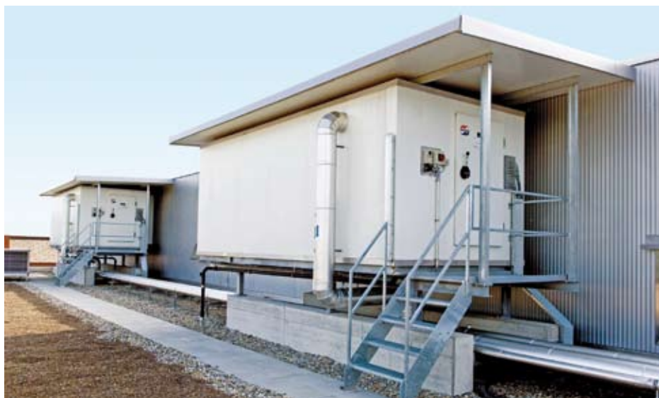
Zwei von vier Güntner-Isolierkühler bei Außenaufstellung in Funktion
