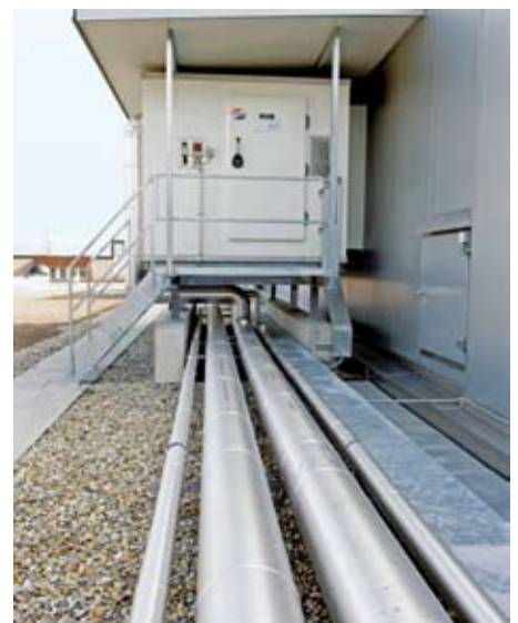
Leitungsführung zu den Isolierkühlern
