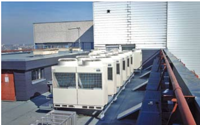
Außeneinheiten auf dem Dach 13 Stück PUHY-P650 YGM-A
