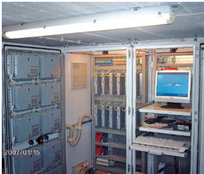
Schaltschrank mit Regelungsmodulen Typ G 50, TG 2000 sowie der SPS-Steuerung und OPC-Serveranbindung
