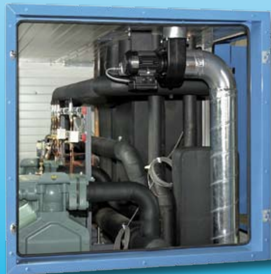
Flüssigkeitskühlanlage mit dem Kältemittel Propan
